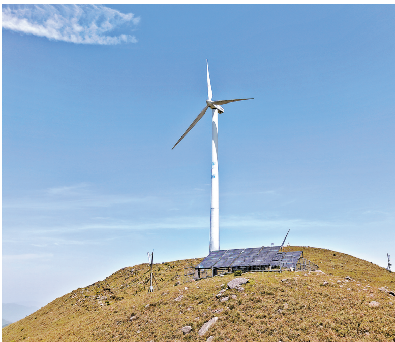
建设全省首个纯光伏基站
